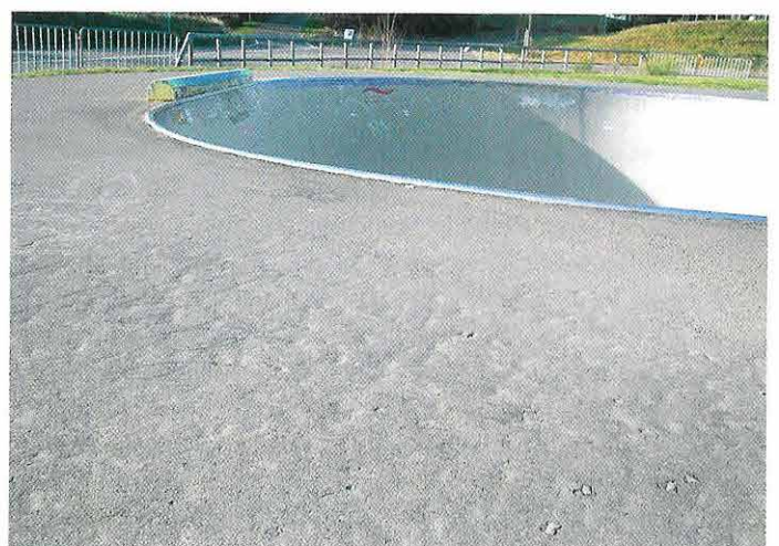
Schadensbild Skatepark mit Asphaltfahrfläche: Unebenheiten/Dellen (durch Skateboardrollen) auf der Asphaltfläche verursacht durch ungeeignete Asphaltmischung. Foto: Axel Reichertz
